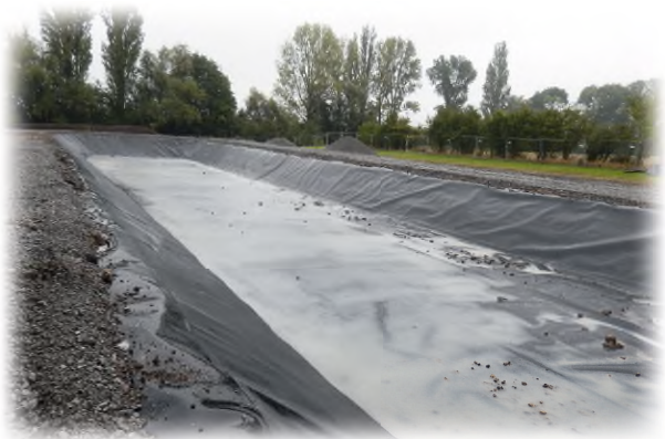
Erdbecken mit Deponiefolie abgedichtet
