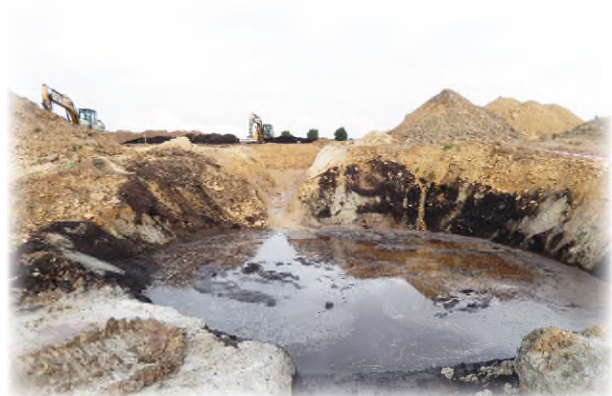
Wasser im Trichter sorgt für Schwierigkeiten bei der Bodenbearbeitung nach der Rekultivierung
